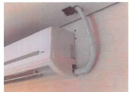
Figura 6 - Defeito na instalação do ar condicionado da sala de audiências
