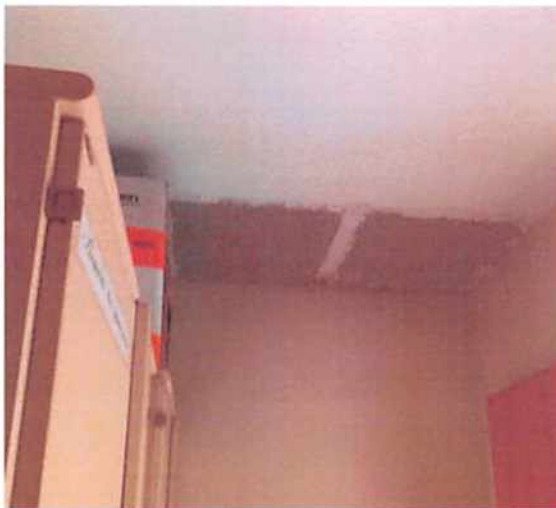
Figura 3 - Defeito no teto da sala anexa à Secretaria
