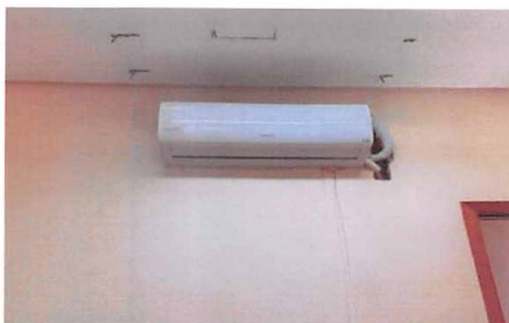
Figura 6 - Central de ar condicionado do Gabinete do Magistrado com acabamento ausente.
