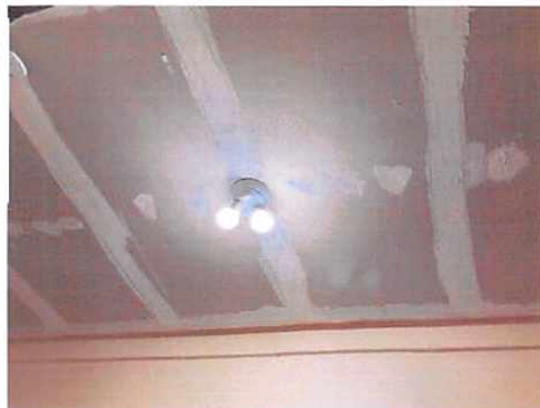
Figura 7 - Local onde o forro de gesso desabou na sala anexa à Secretaria, onde verifica-se, também, a restauração realizada com serviço de pintura pendente.
