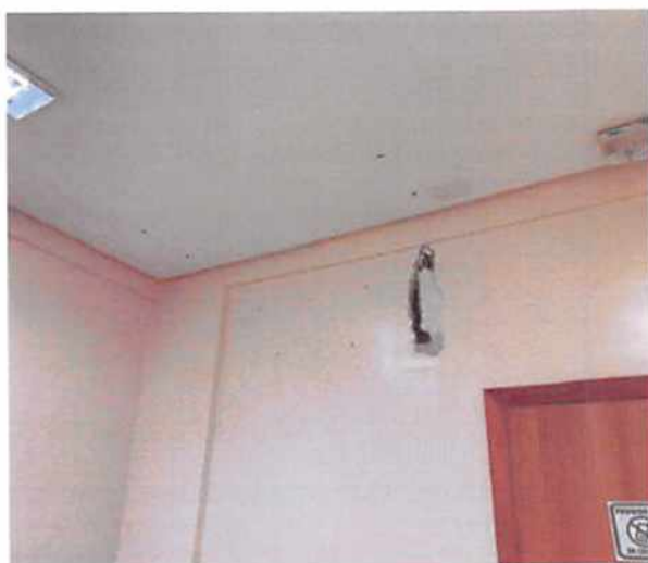
Figura 10 - Local, na Sala de Audiências, de onde foi retirada a central de ar-condicionado.
