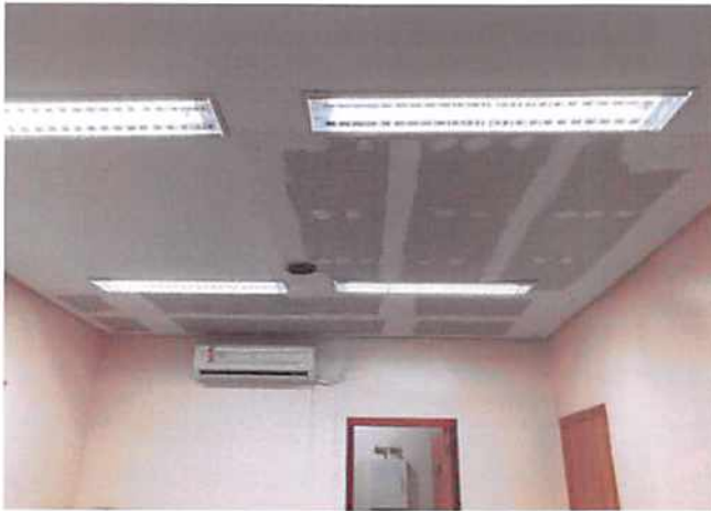
Figura 6 - Local do desabamento do forro de gesso após restauração. Verifica-se pendente a pintura no local.
