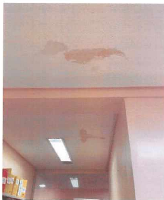
Figura 3 - Infiltrações no teto da Secretaria
