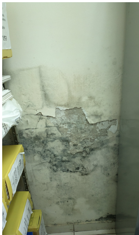
SECRETARIA – ATENDIMENTO - INFILTRAÇÃO
