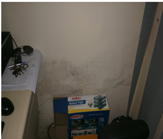
SALA DE AUDIÊNCIAS - INFILTRAÇÃO
