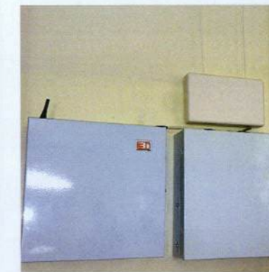
CENTRAL DE ALARME E GPRS
