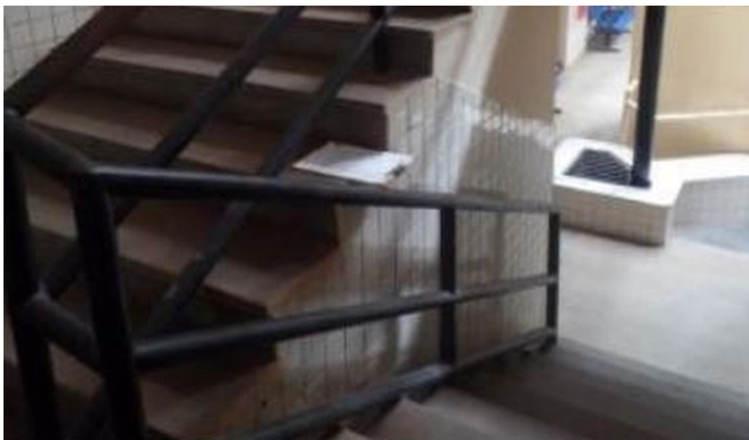
Estruturas do prédio não têm acessibilidade, em Santarém — Foto: MPPA/Divulgação
